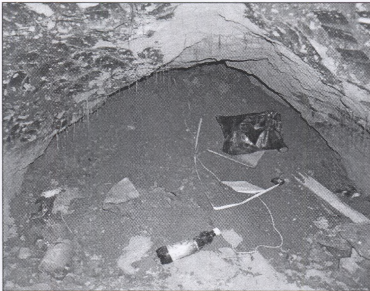
Рис. 2. Вигляд з кінця печери, розташованої на вул.Яранській, в тунель, що підходить до неї. Фото А.Л.Щербаня.
